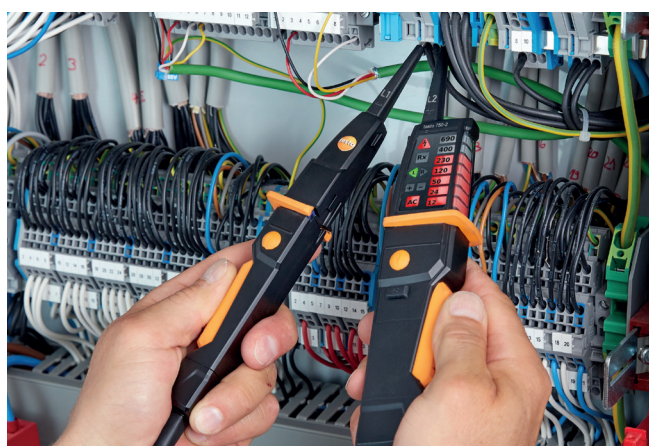
Misura della tensione in un quadro elettrico.
